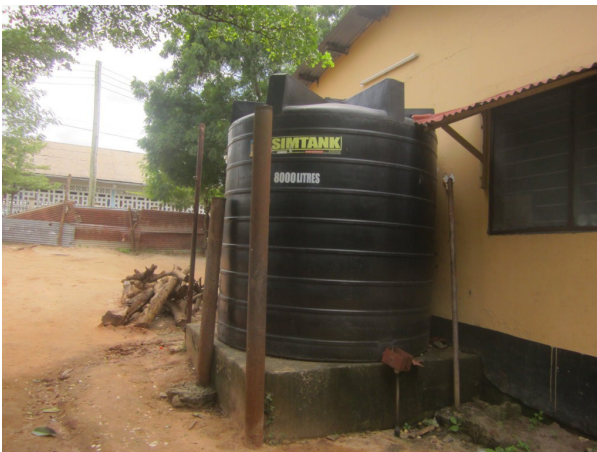
Der bisher einzige Wassertank &
